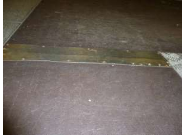
Foto 5376; traanplaat kapot vervangen sp. 8.
